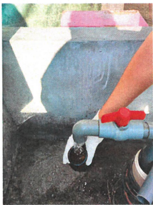
地下水检测井 (1)
